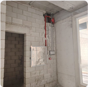
نظام إنذار ومكافحة الحريق - ت... 2026/01/24 02:03 PM
