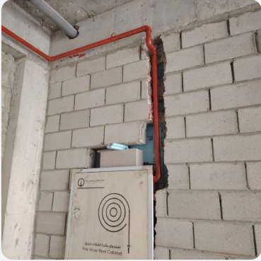
نظام إنذار ومكافحة الحريق - ت... 2026/01/24 02:03 PM
