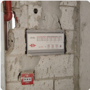
نظام إنذار ومكافحة الحريق - ت... 2026/01/24 02:03 PM
