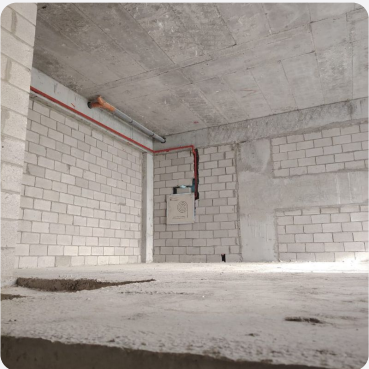
نظام إنذار ومكافحة الحريق - ت... 2026/01/24 02:03 PM
