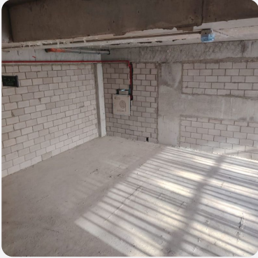
نظام إنذار ومكافحة الحريق - ت... 2026/01/24 02:03 PM
