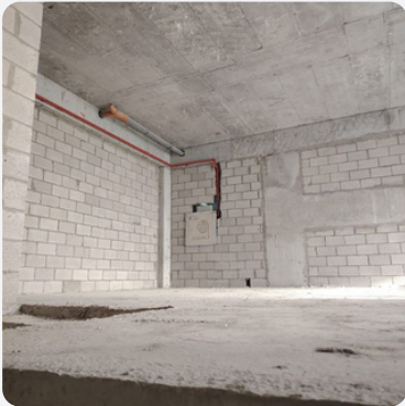
نظام إنذار ومكافحة الحريق - ت... 2026/01/24 02:03 PM
