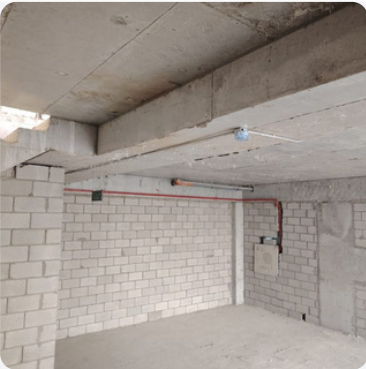
نظام إنذار ومكافحة الحريق - ت... 2026/01/24 02:03 PM
