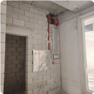
نظام إنذار ومكافحة الحريق - ت... 2026/01/24 02:03 PM
