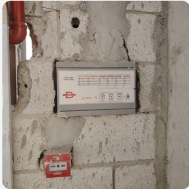
نظام إنذار ومكافحة الحريق - ت... 2026/01/24 02:03 PM
